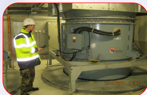
Usine de ventilation - Tranchée couverte Angers
