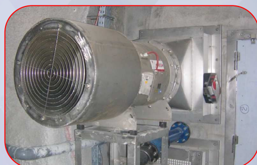
Mise en surpression de sas ou issue de secours
