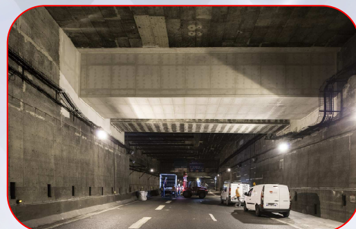
Gaines de désenfumage N3 Puteaux - A14
