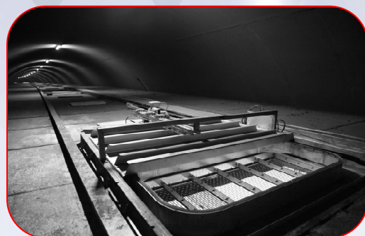
Trappes de désenfumage (brevet Yvroud) - Tunnel sous Fourvière
