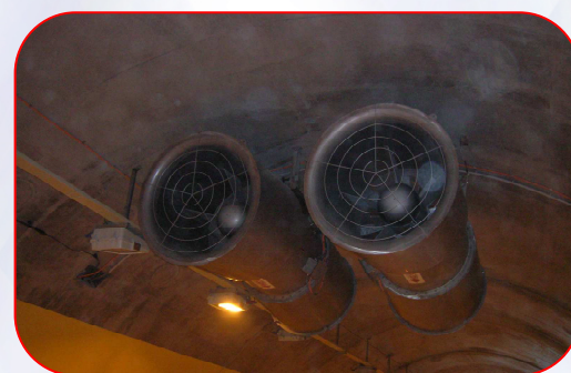
Accélérateurs type "banana" Tunnel du Sinard
