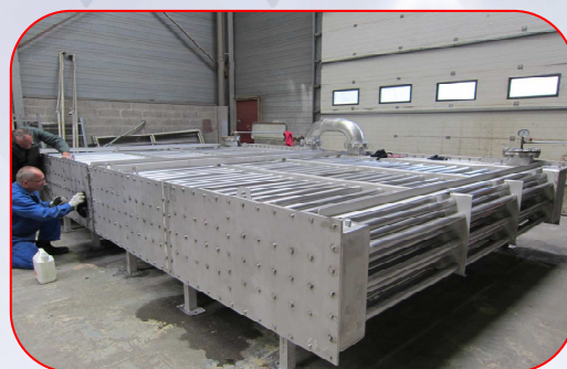
Echangeur de chaleur – EdF – La Réunion
