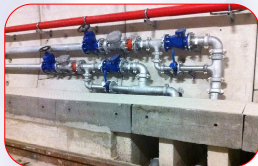
Poste d'épuisement pluvial - RATP
